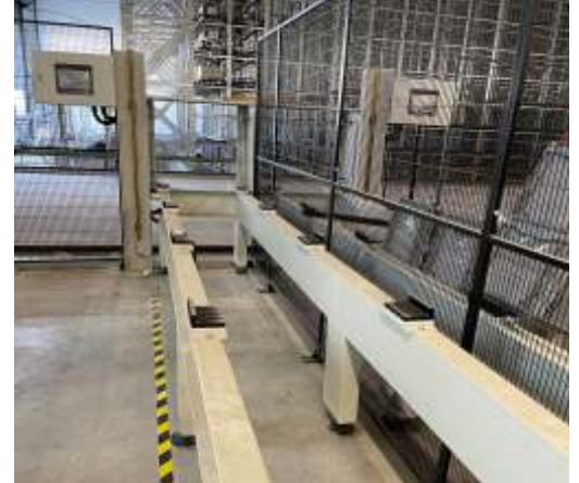
Baia di scarico Unloading bay
